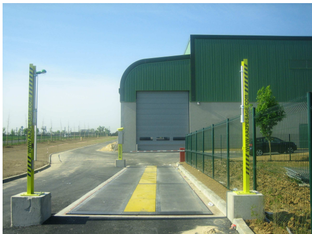
Pont-basculé AAZ300 EF ( Entrée) avec détecteur de radioactivité
